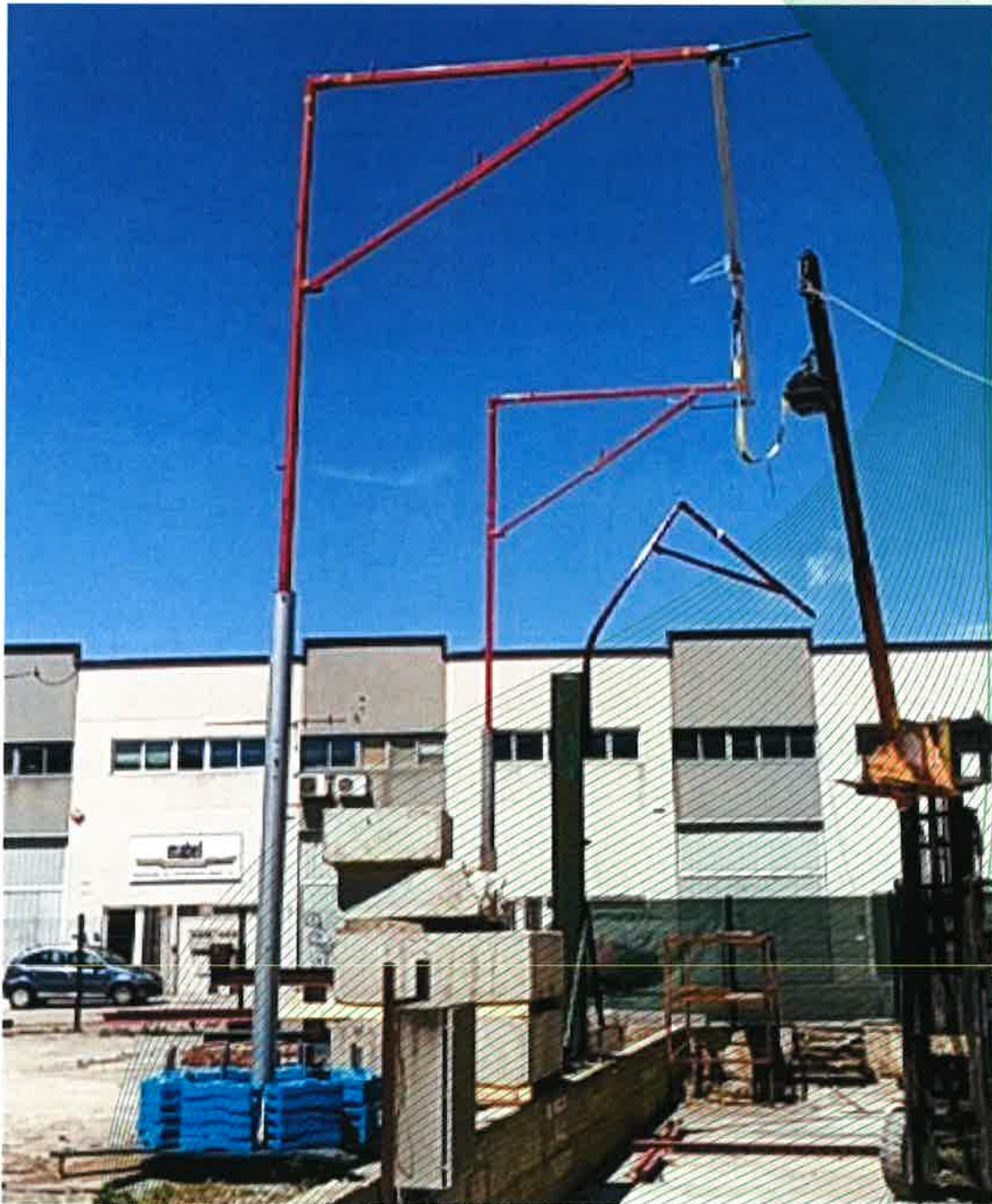
Ilustración 4: Dispositivo de anclaje del tipo D (tipo: Horizontal Safeaccess y NAV2 trolley / fabricante: FALLPROTEC SA) con anclajes, tipo: AluPercha y Mobile base units
